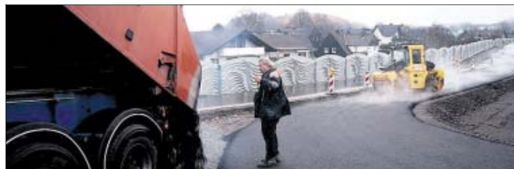
Zwischen Trotzenburg und Handweiser wird wieder geteert. Die Behelfstrasse wird jetzt auf das endgültige Niveau gebracht.
